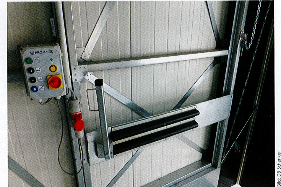
Festhaltevorrichtung im Loadhouse für geöffnete Lkw-Türen.
